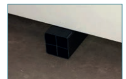
Chevrons d'aération du sol
